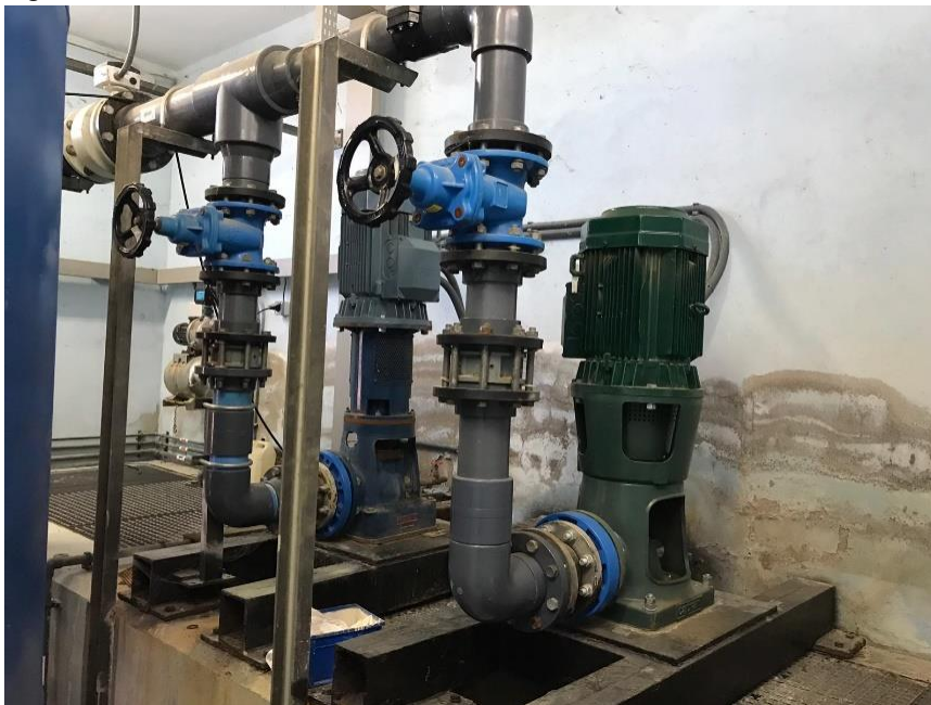
Fotografia 5. Bombes d'elevació als filtres
