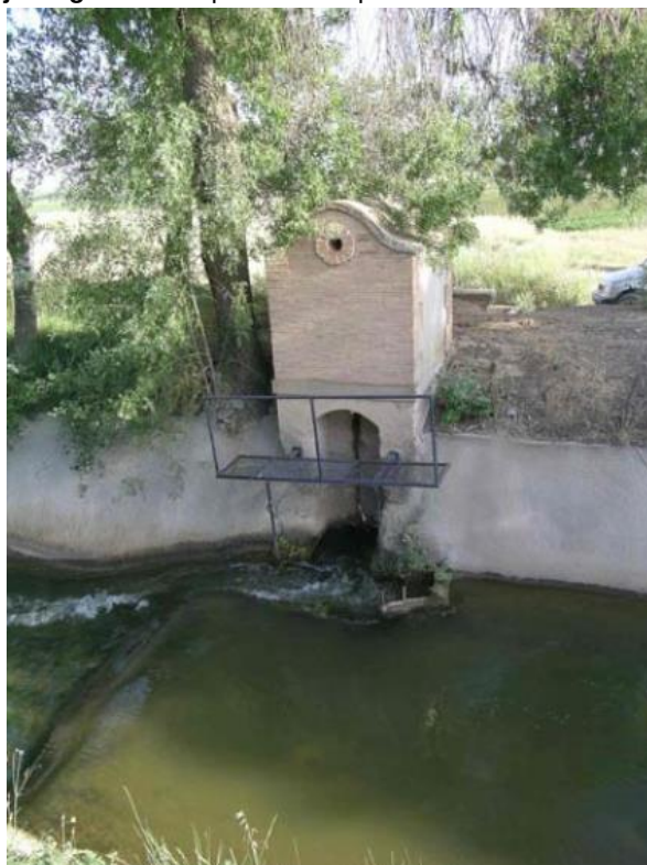
Fotografia 1. Captació 4ª sèquia
