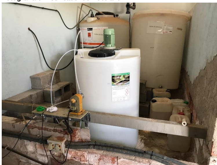
Fotografia 6. Dosificador del floculant
