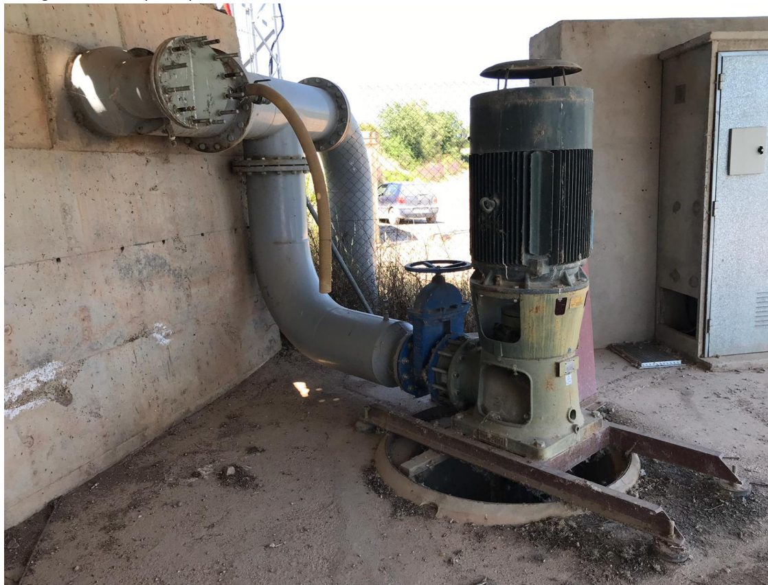
Fotografia 15. Grup d'impulsió de l'Embassament 33
