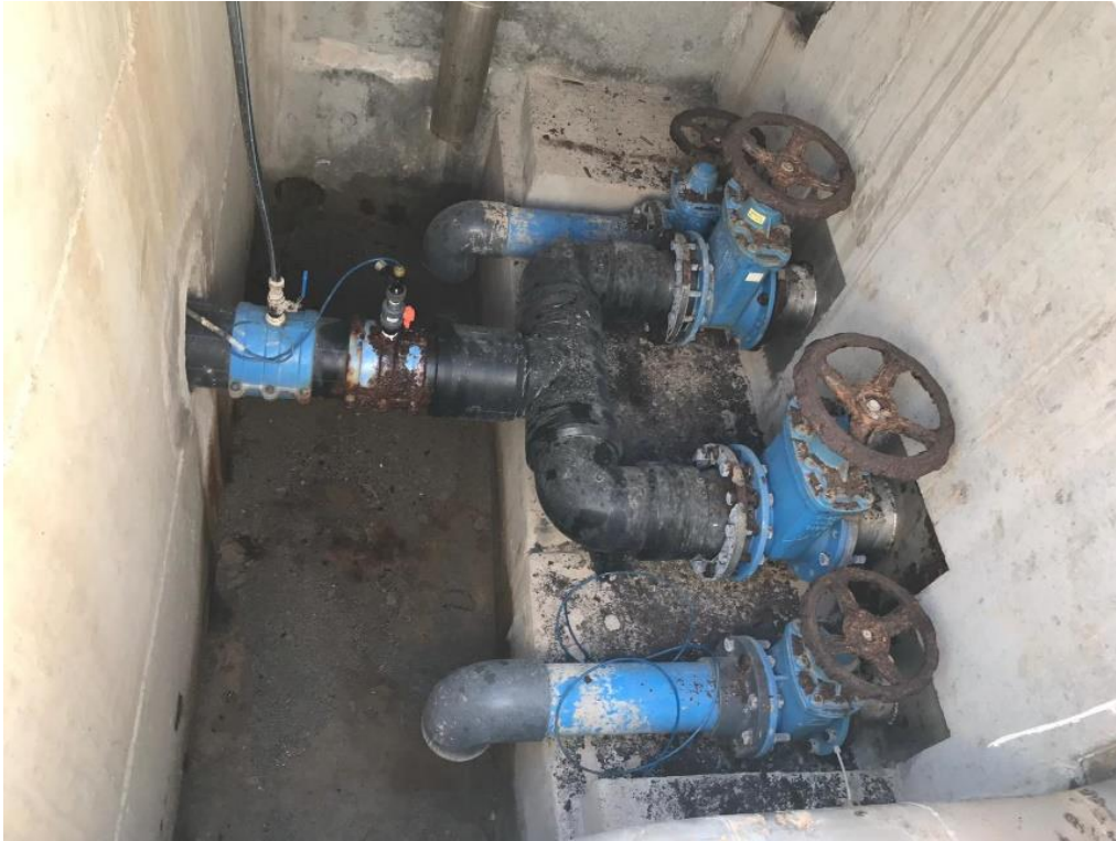
Fotografia 11. Punt d'injecció d'hipoclorit sòdic a la sortida del dipòsit d'aigua potable.
