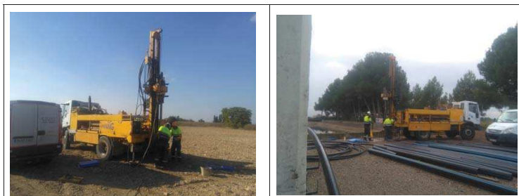
Sonda Tecoinsa TP-50 muntada sobre camió
